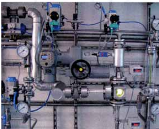
▲ MEX5, ED701 und ETTN im Schulungszentrum, Bereich Verfahrenstechnik
